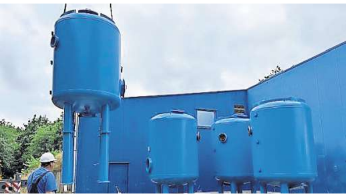
Der Wasserverband Nienburger Land hat die Filtrationsanlage im Wasserwerk Drakenburg erneuert und erweitert. FOTO: WASSERVERBAND
