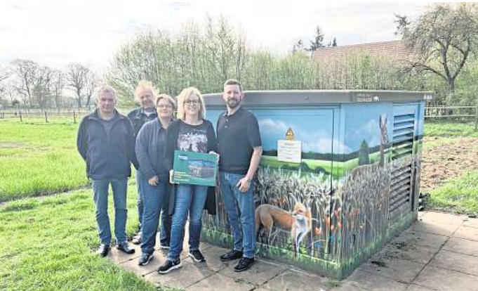
Der Trafo am Rottbach in Kleinenheerse kam im Jahr 2023 auf Platz 3.
