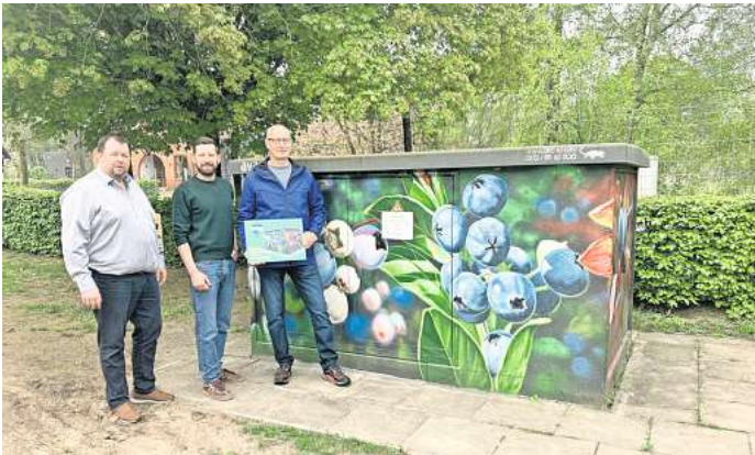
Die Station am „Jägerkrug“ in Sonnenborstel belegte im Jahr 2023 Platz 2.
