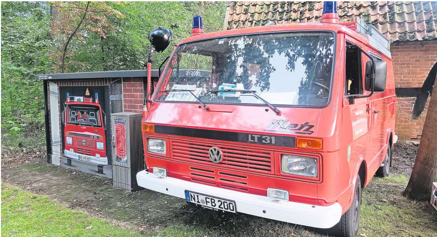
Auf der Avacon-Trafostation in Bötenberg ist das Feuerwehrauto abgebildet. Hier steht das Original neben dem Trafo.
