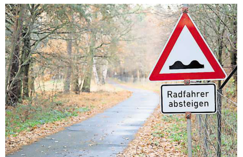
Radfahrer absteigen! Nördlich von Rothenburg in Sachsen ist der Oder-Neiße-Radweg so stark beschädigt, dass ein Schild davor warnt. FOTO: ANDRÉ SCHULZE
