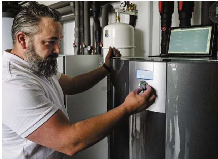
Mit Profi-Unterstützung gelingt die Wärmewende im Zuhause: Fachhandwerker begleiten die Modernisierung von der ersten Planung bis zur Inbetriebnahme der Wärmepumpe. Foto: DJD/Bundesverband Wärmepumpe/Bernd Lauter
