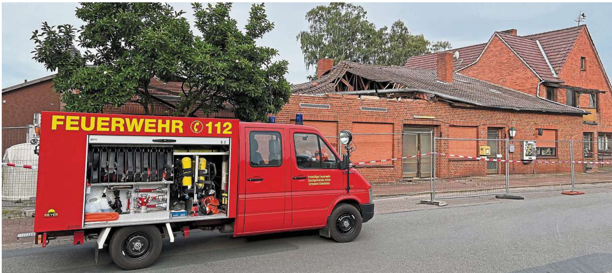
Der Saal des ehemaligen Gasthauses Rösener in Steinbrink ist eingestürzt.
