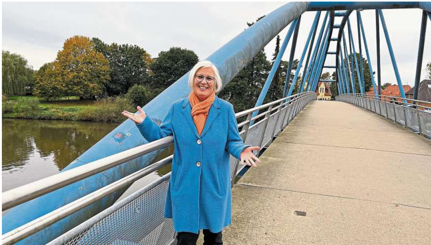
Die Fußgängerbrücke über die Weser ein Foto mit Symbolcharakter, denn Superintendentin Dr. Christiane de Vos wohnt zwar in Nienburg, ist aber für den gesamten Kirchenkreis zuständig. FOTOS: HEIDI RECKLEBEN
