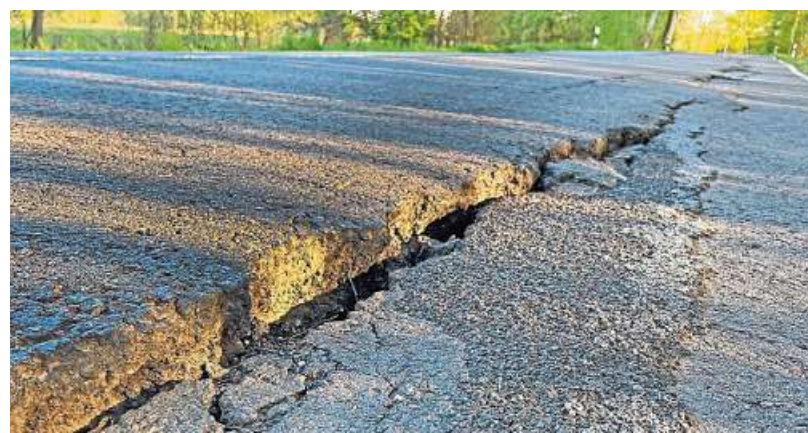
Bis zu zehn Zentimeter Höhenunterschied bedeuteten Lebensgefahr für Biker: Mittlerweile sind die schlimmen Abrisse wieder mit frischem Asphalt begradigt.
