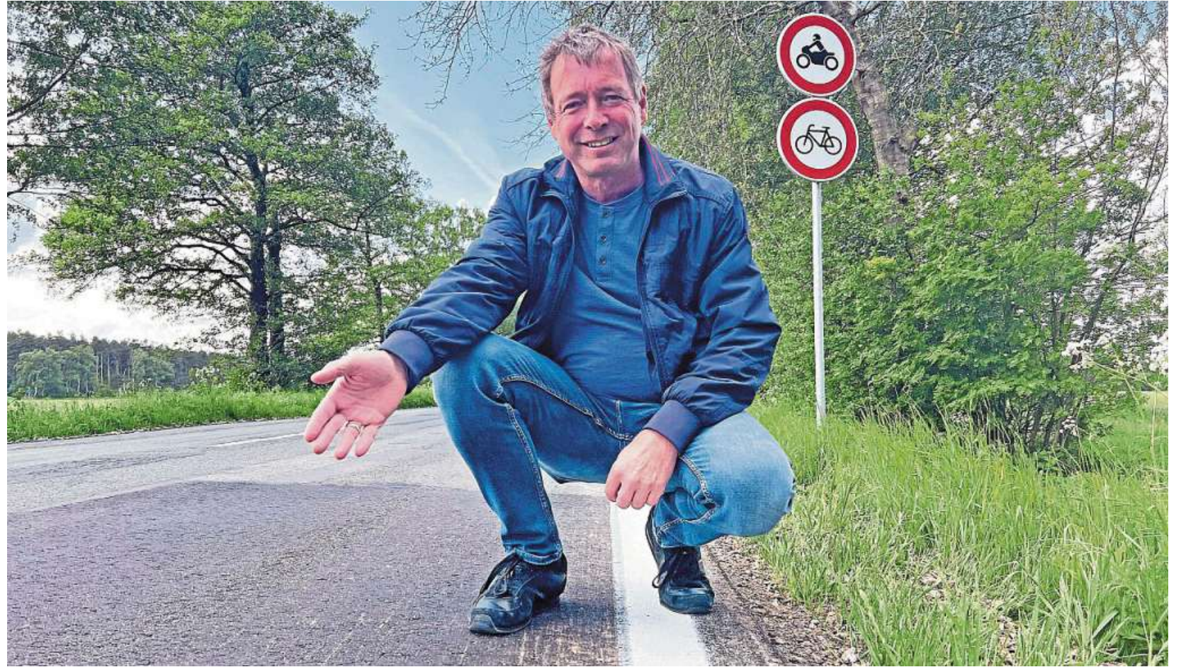
Hans Lindemann deutet auf eine geflickte Stelle auf der K 37. Das Verbot für Biker und Radler gilt aber weiter, weil das letzte Stück von 350 Metern Länge erst ab dem Sommer über ein Pilotprojekt saniert wird.
