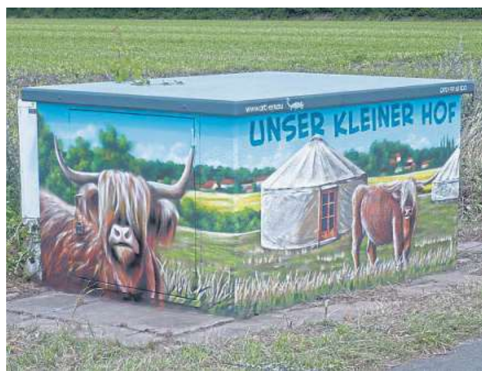
So sieht jetzt das Traföhäuschen an der Heidestraße in Wietzen aus. FOTOS: AVACON (2)
