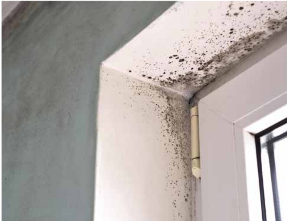
Feuchtigkeit in den Wänden kann zu gesundheitlichen Problemen führen.
