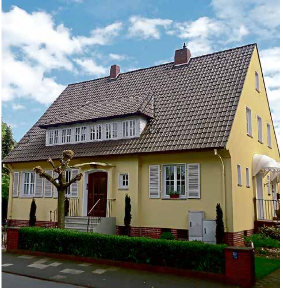
Sanierte Fassade, aber veralgtes Dach.
