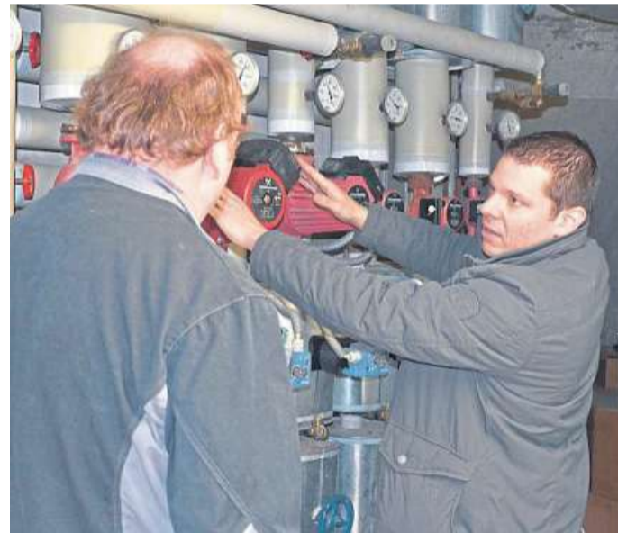
Energieberater Jan Norrmann (rechts) gibt wichtige Hinweise zur Einstellung der Heizungspumpen. FOTO: KLIMASCHUTZAGENTUR MITTELWESER
