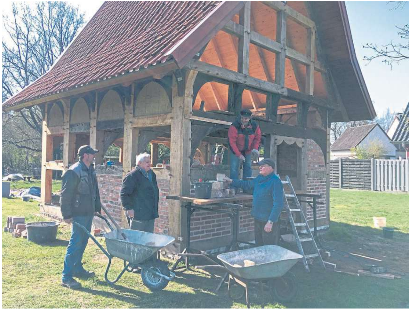
Nach Ende der Winterpause werden die Arbeiten an der künftigen „Hochzeitsschmiede“ im Garten hinter „Witten Hus“ in Liebenau zügig fortgesetzt. FOTO: SOMMERFELD
