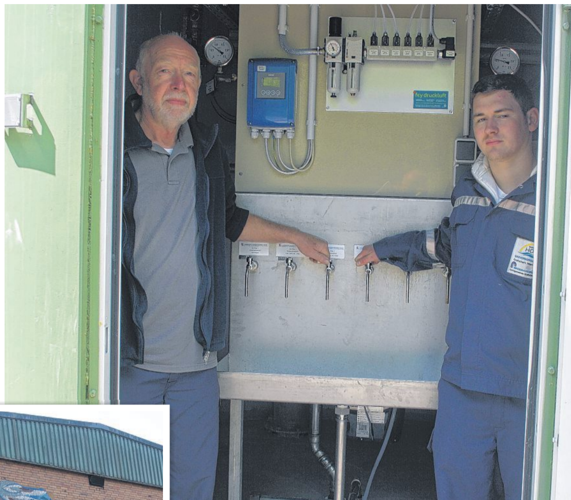
Die moderne Aktivkohlefilteranlage am Wasserwerk wird am Tag der offenen Tür geöffnet. Rolf Verheyen und Lehrling Niklas Schmidt geben einen Blick in einem der Kessel.
