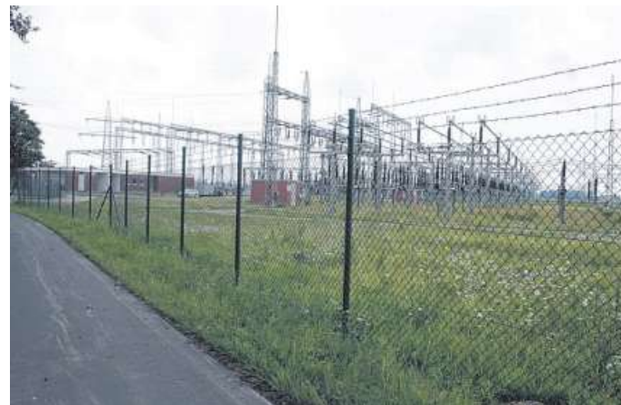
Das Umspannwerk Wechold steht auf einer Fläche von 3,5 Hektar. Die Samtgemeinde ist mehrheitlich für eine Erweiterung für die Stromtrasse Stade-Landesbergen.
