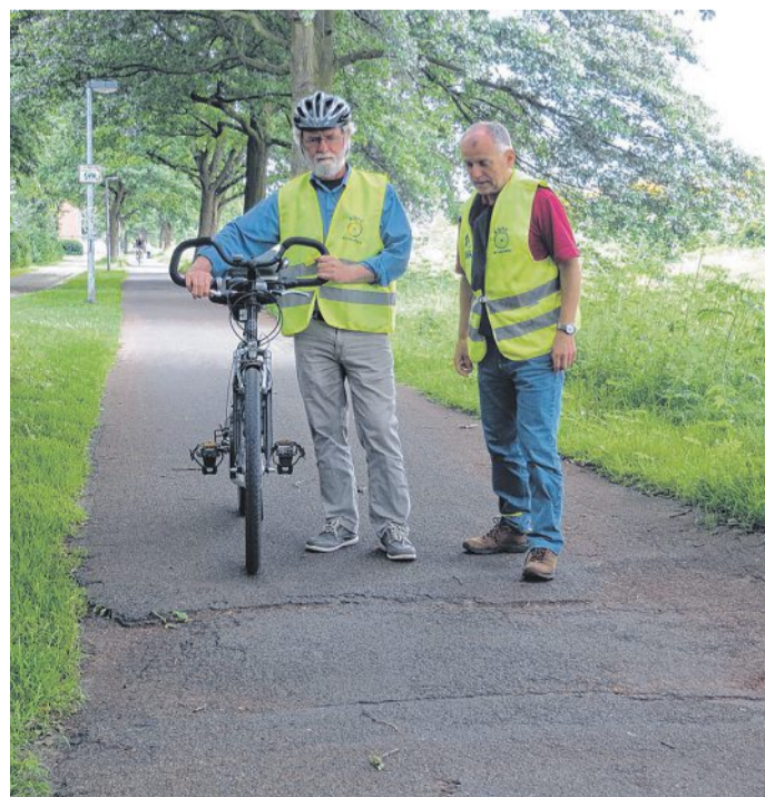
Ralf Schwittling (links) und Berthold Vahlsing betrachten die zunehmenden Schäden am Wilhem-Siebert-Weg. „Wir haben bereits seit Jahren ohne Erfolg auf den Missstand hingewiesen“, so die beiden ADFC-Aktiven.
