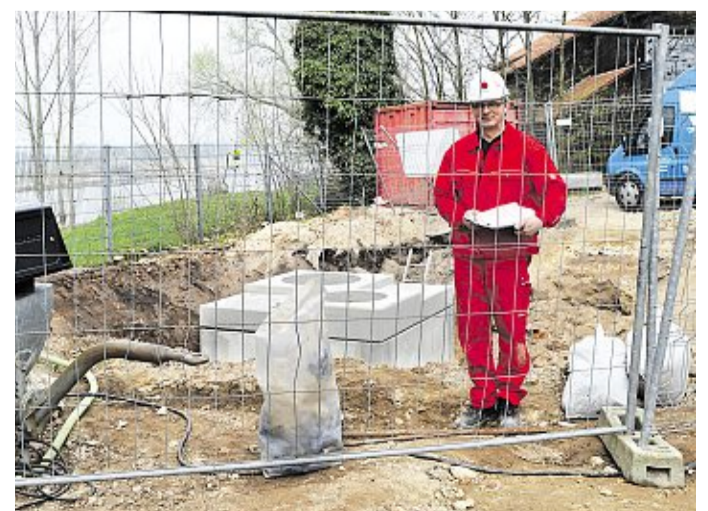
Noch ist der Solebrunnen von einem Bauzaun umgeben. Mittlerweile ist er auch von oben abgedichtet. Bernd Werfelmann, Mitarbeiter der Firma Wöltjen, war am Montag vor Ort, um die Arbeiten zu beaufsichtigen.
