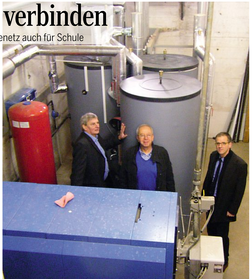
Nahwärme in Betrieb: Im Heizungskeller der Grundschule Rodewald stehen die Gasheizung (vorne), Verwaltungschef Hans-Jürgen Hoffmann (links), Naturwärme-Geschäftsführer Gerhard Schierkolk (Mitte) und Jan-Hendrik Krohn. Dahinter die drei Wärmespeicher mit jeweils 1000 Liter Fassungsvermögen. Reckleben (2)
