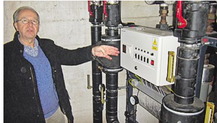
Im Keller der Rodewalder Grundschule: Gerhard Schierkolk erläutert die Übergabetechnik des Nahwärmesystems in den Heizungskreislauf.
