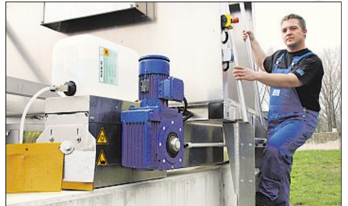
11 Kläranlagen-Betriebsleiter Michael Wulff hält die Anlage auf Vordermann. Die Besucher können kommen.
