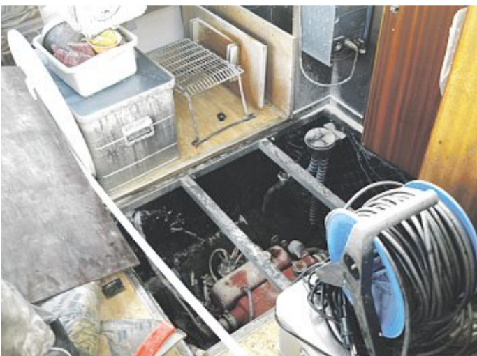
Im Motorraum dieses Sportbootes kam es zur Explosion.
